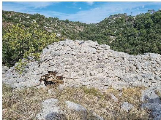
Slika 15. - Rupa u zidu na lokaciji 1.
